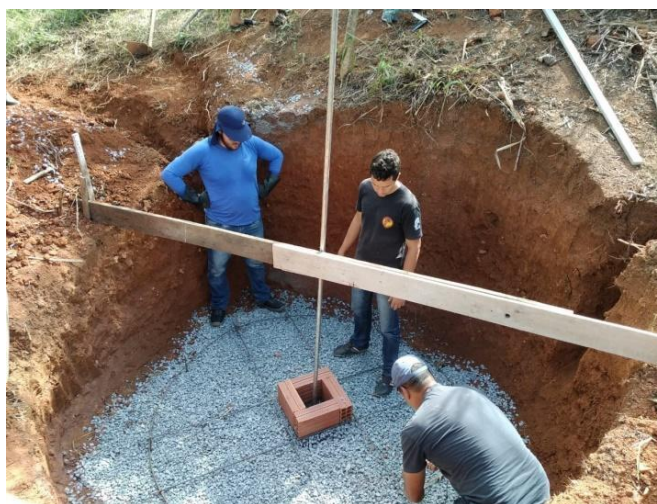
Figura 7 - Base do biodigestor.
