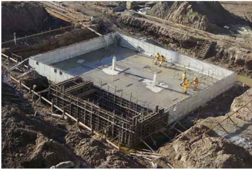
Figura 14: Cisterna de até 300m 3 , Cidade do Samba - RJ
