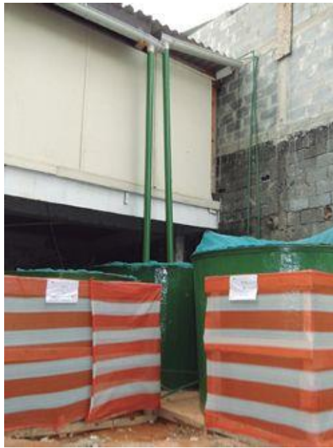
Figura 5: Calha e condutores de um sistema de aproveitamento de chuva
