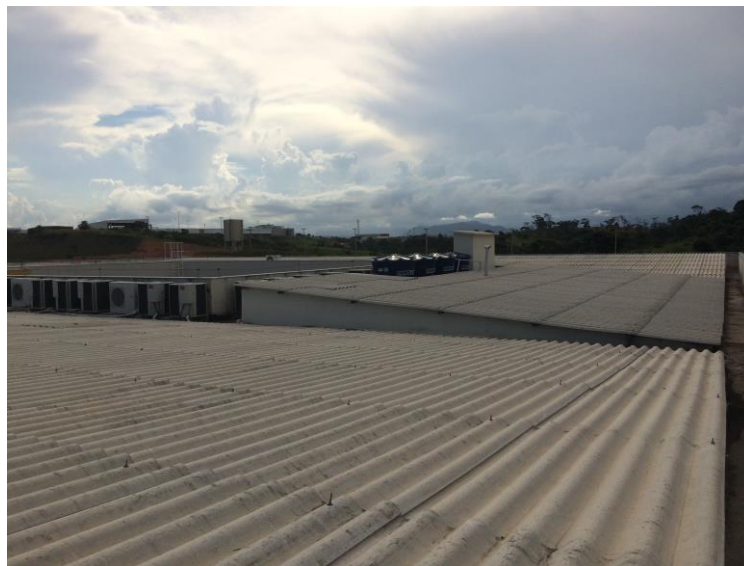
Figura 4: Área de captação de um sistema de aproveitamento de chuva
