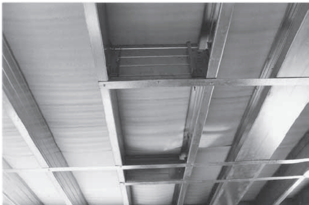
Figura 2.12 – Exemplo de utilização de fitas de aço para contenção lateral de vigas de piso.
