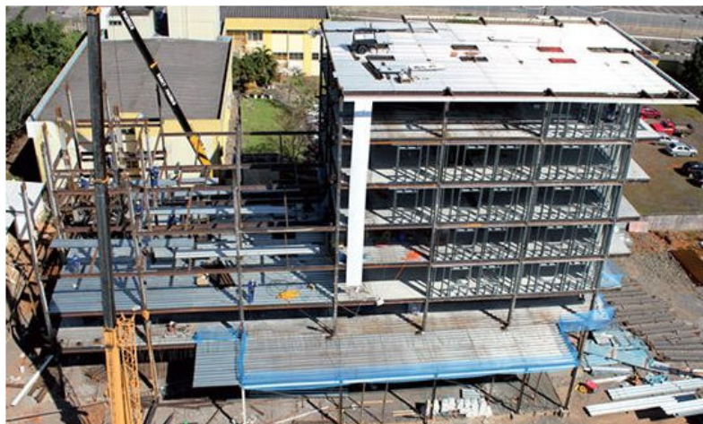
Figura 1.4 – Construção de um hotel em Estruturas Mistas de aço e concreto e laje de Steel Deck , (Tamaki, Estrutura rápida, Técnica, 2011).
