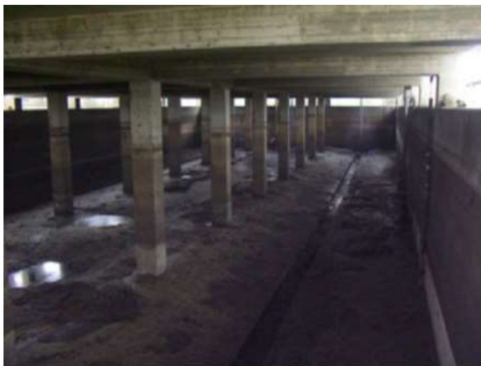
Figura 4: Reservatório de retenção subterrâneo. Fonte: ABCP (2013).
