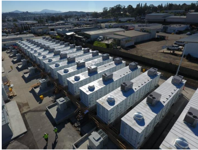
Figura 30 - Usina de armazenamento de energia na Califórnia.
