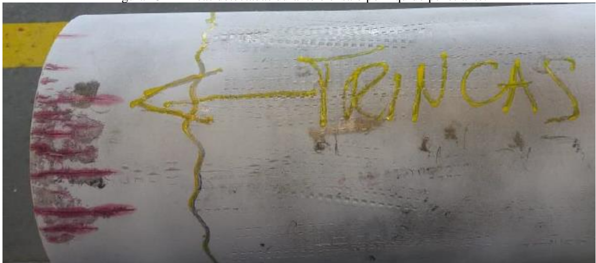
Figura 15 - Trincas detectadas durante o ensaio por líquido penetrante.
